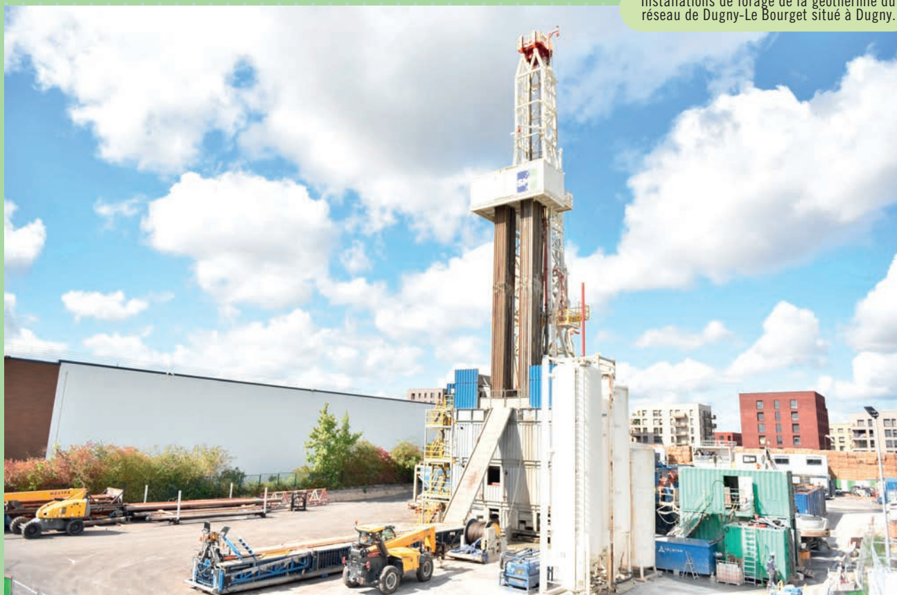
Installations de forage de la géothermie du réseau de Dugny-Le Bourget situé à Dugny.
