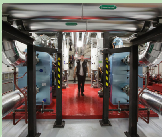
Centrale géothermique du Blanc-Mesnil.
